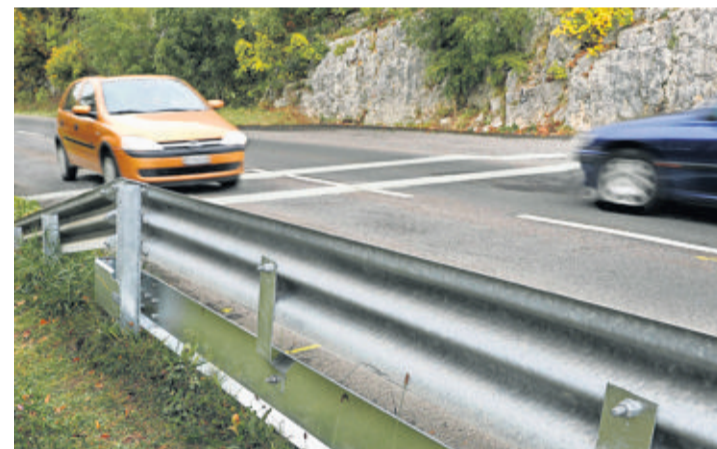
Les glissières doubles évitent aux conducteurs de deux-roues de passer dessous en cas de chute. ALAIN ROUËCHE
